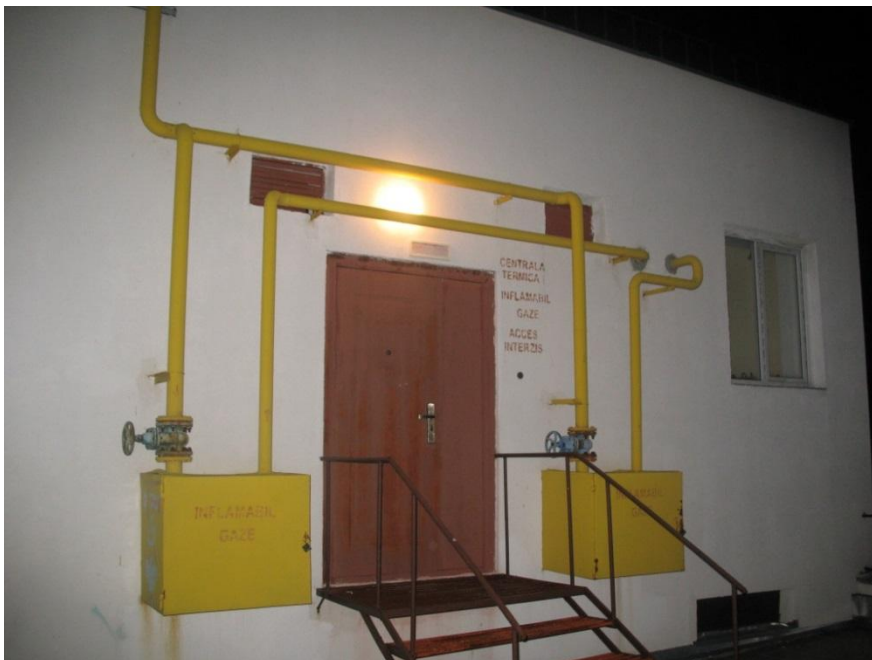
Figura 2. Vederea intrării în centrala termică
