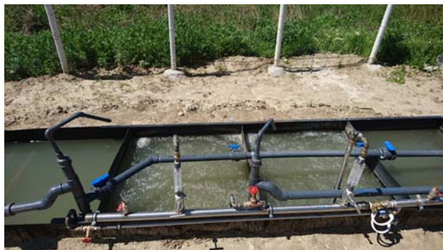
Figura 1. Instalația – pilot. De la dreapta la stânga compartiment anoxic, două compartimente aerobe, decantor lamelar.
