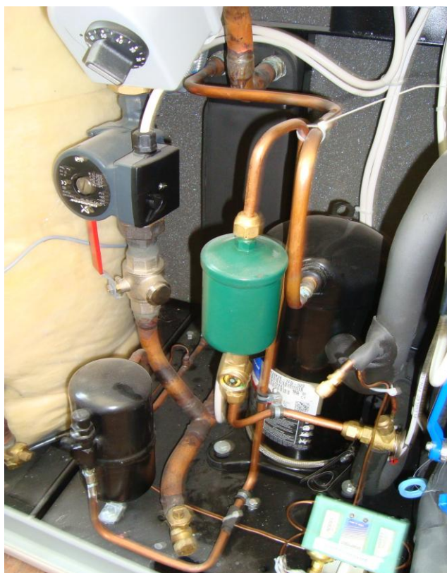
Fig.1. Pompa de căldură.
