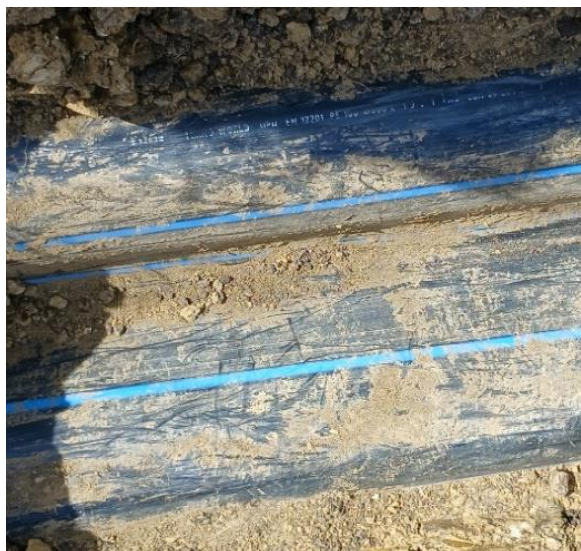
Foto. 5. Tub deformat în săpătură
