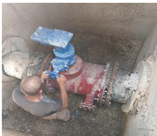
Foto 2. CA 5. Cămin cu vană și clapetă de aerisire
