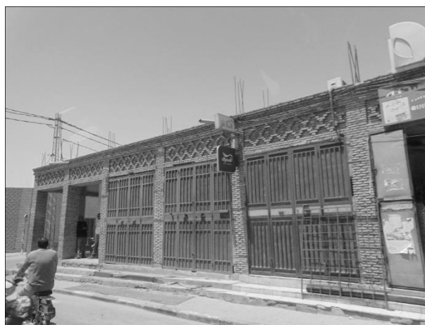
Figura 2. Construcție aparent nefinalizată din Tunisia - a se vedea „mustășile de armătură” de la partea superioară, în contrast cu finisajele exterioare. Sursa imaginii: Alexandru-Ionuț Petrișor, 2024.
