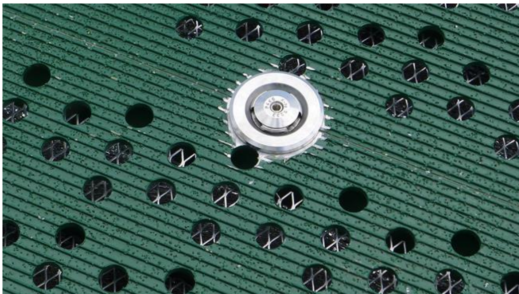
Figura 2. Cap de sprinkler pentru heliport (surse proprii)
