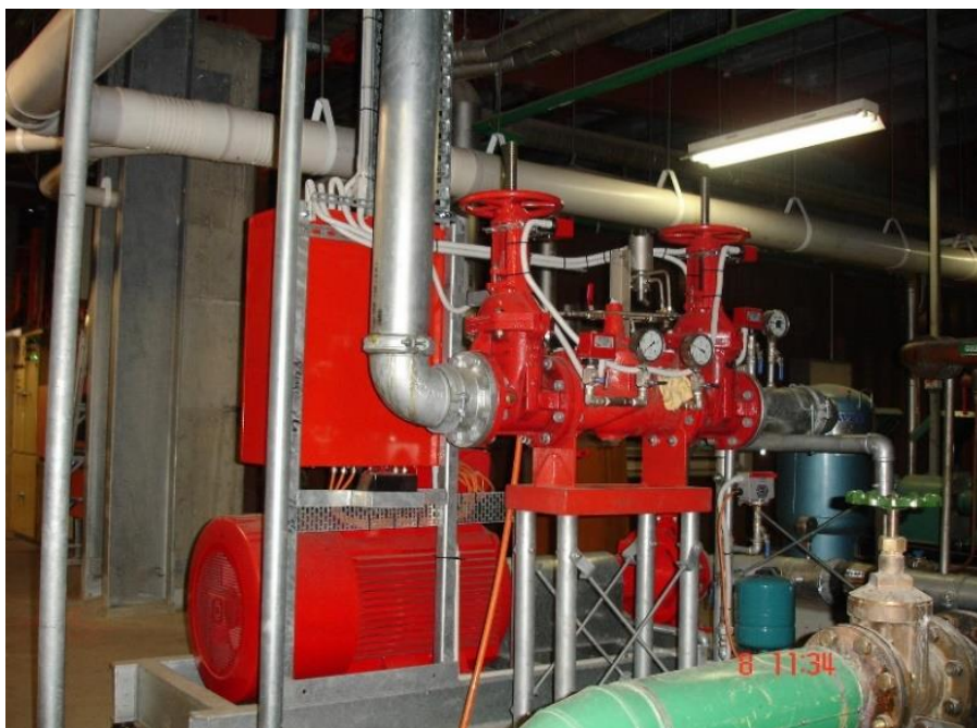
Figura 1. Grupul de pompare hidranti și sprinklere (surse proprii)
