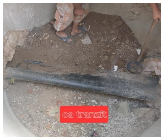
Foto 3. Tub deformat în cămin
