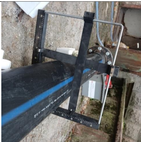
Foto 9. Măsurarea dimensiunilor tubului deformat
