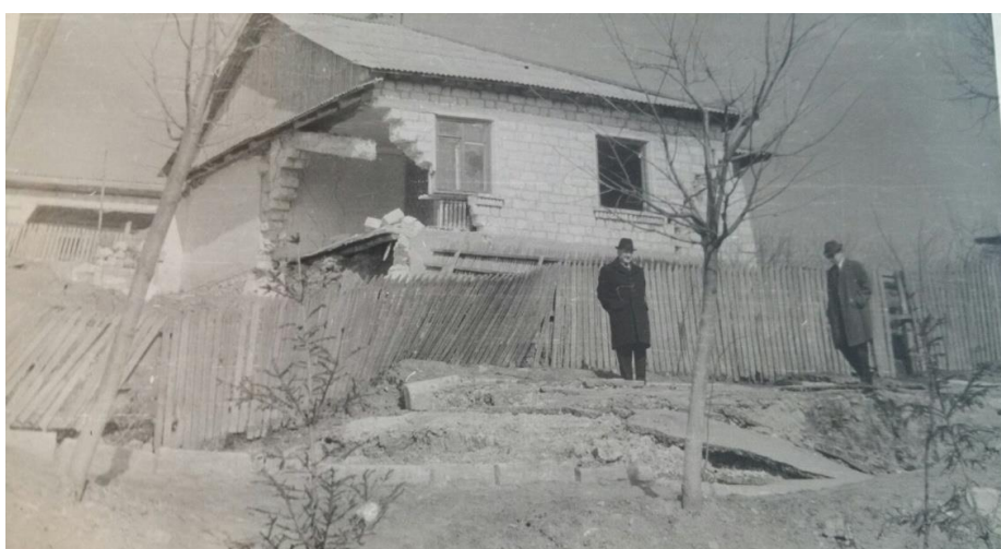
Figura 2. Rogacevschii I.A., conf. univ., dr. și Abramenco P.Gh., conf. univ, dr. al departamentului GITF, în procesul studiului tehnic și geotehnic al casei de locuit, distruse în urma alunecării de teren în raionul Hâncești, 1970.
