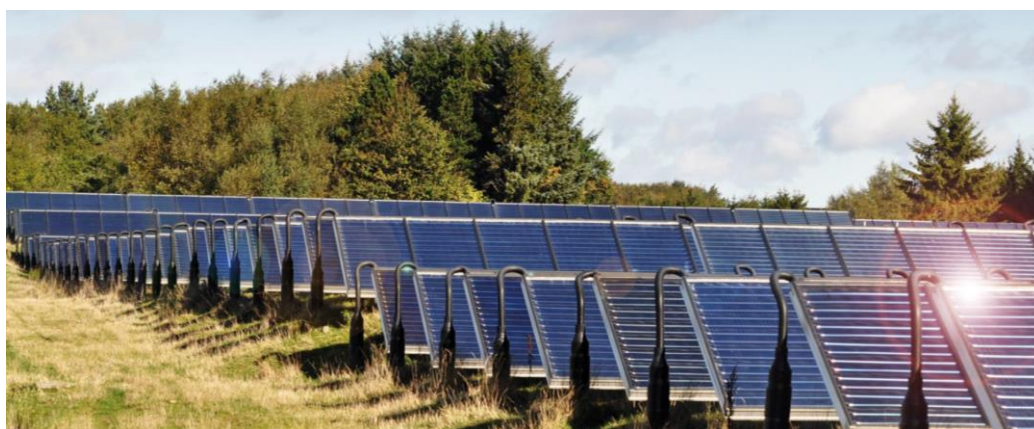
Figura 1. Câmp de colectoare solare termice [1]
