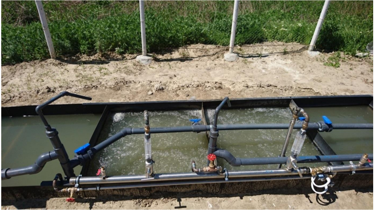
Fig. 2.3. Instalația-pilot de epurare a apelor uzate asupra căreia au loc experimentele. De la dreapta la stânga: bioreactor anoxic, bioreactor aerob, bioreactor aerob, decantor lamelar
