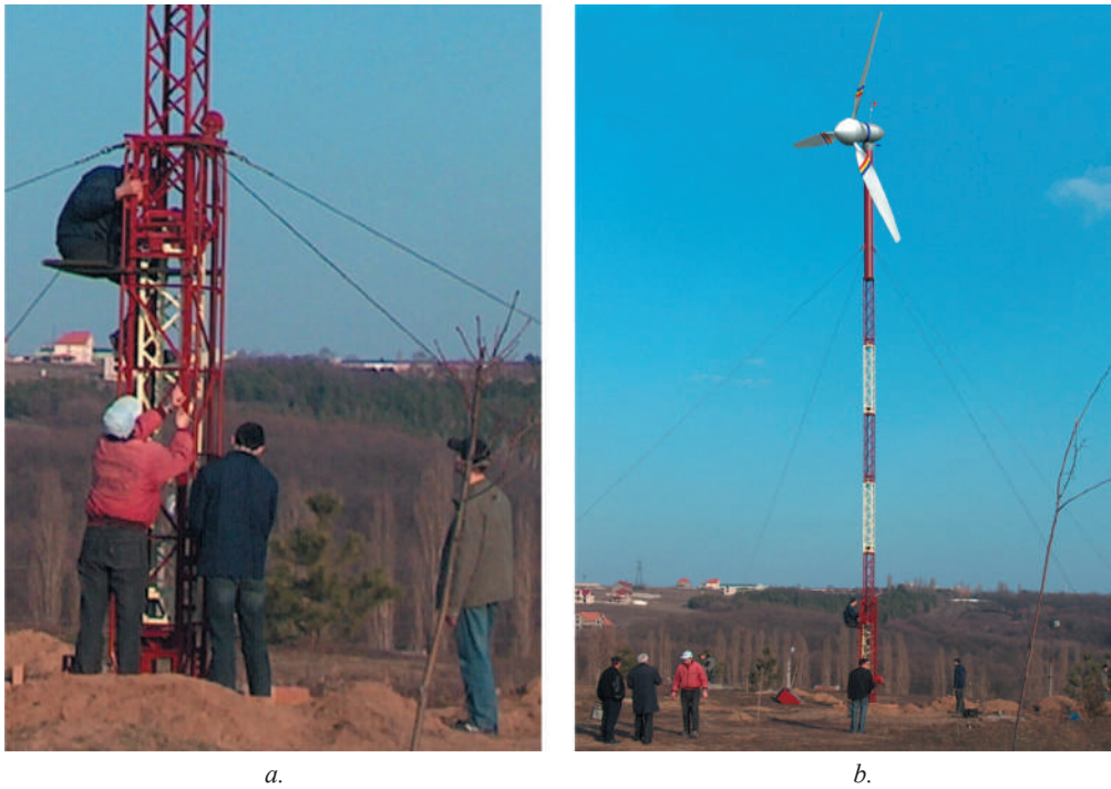
Fig. 4.56. Montarea turlei telescopice (a) și a turbinei eoliene cu servomotor (b) instalată în campusul Râșcani, UTM.
