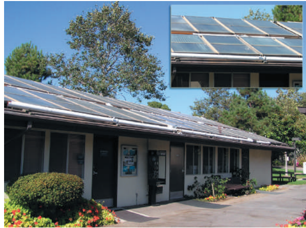
Fig. 2.96. Panouri solare instalate pe acoperișul unei case de locuit.
