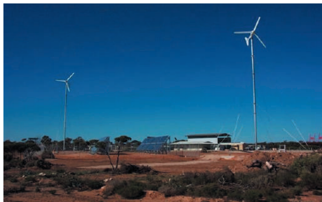
Fig. 4.47. Două turbine WestWind cu puterea de 10kW instalate la stația Euda (Australia).
