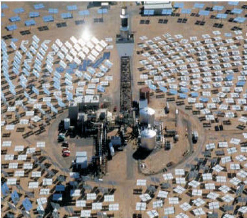
Fig. 2.66. Centrala termică solară Solar Two [51].
