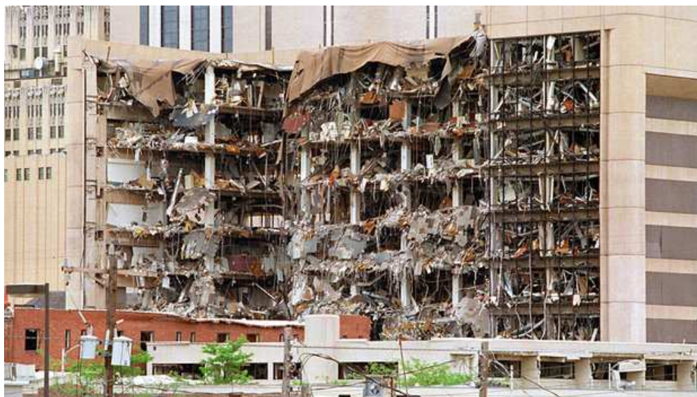
Figura 2 - Clădirea Federală Alfred P. Murrah, Oklahoma, S.U.A.
