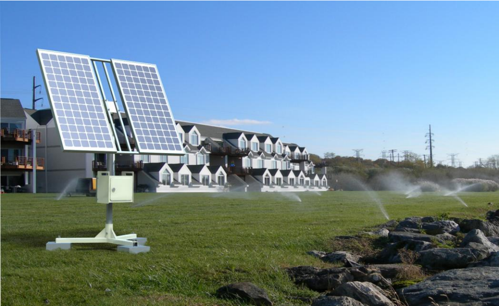
Fig. 6. Instalație fotovoltaică de irigare cu orientare la soare în regim automat.
